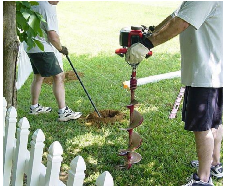
Figure 4 - Avant d'entreprendre tout type d'excavation, les propriétaires fonciers doivent d'abord communiquer avec les autorités compétentes pour s'assurer qu'il n'y a pas de risque d'endommager des installations souterraines.
